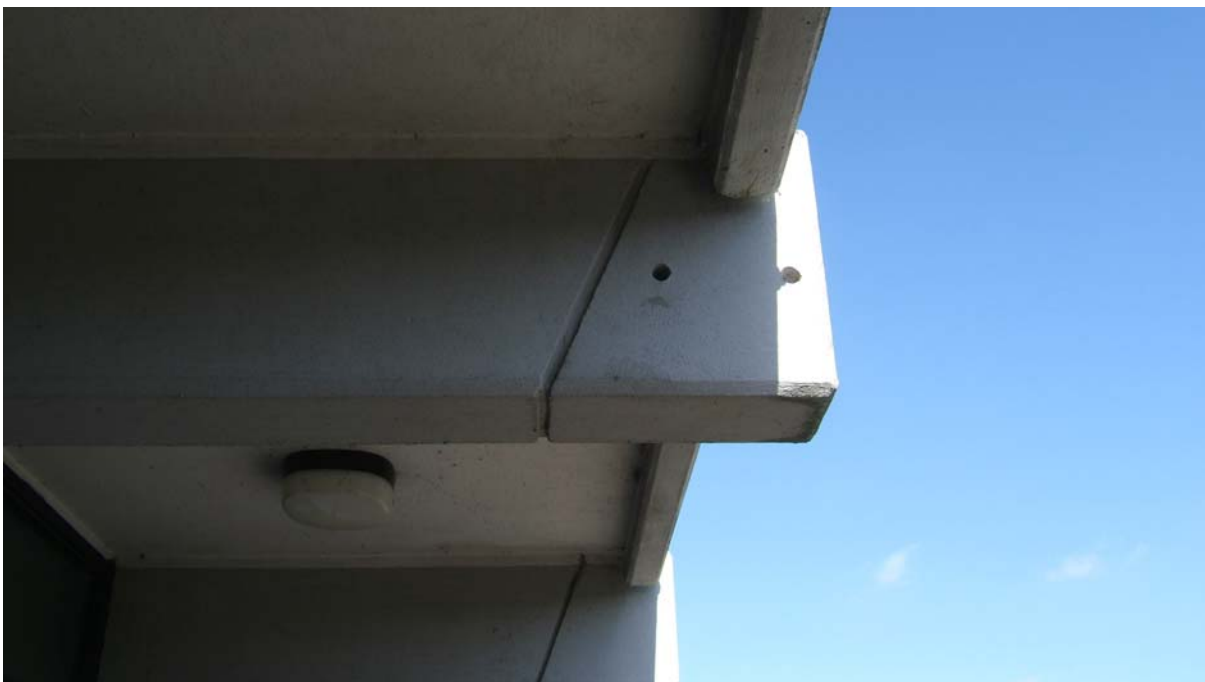
Foto 15: Område 3 3E/F, hvor der er udtaget chloridprøver 2 steder nær konsolende (se borehuller).
