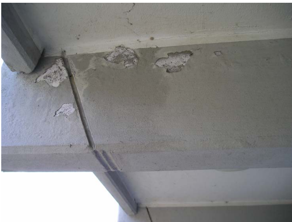
Foto 3: Det er (har været?) fugtgennemsvivning gennem fuger over konsoller.
