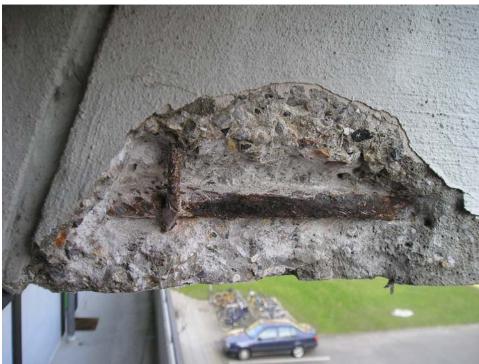
Foto 6: Ophugning 2. Yderste på konsol. Rustgrad 2 – 3 midt i ophugningen.
