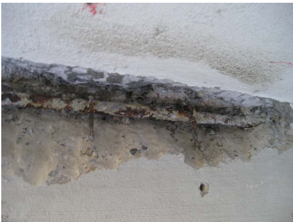
Foto 4: Ophugning 1 øverst på konsol. Nærmest bygningen er der rustgrad 1.
