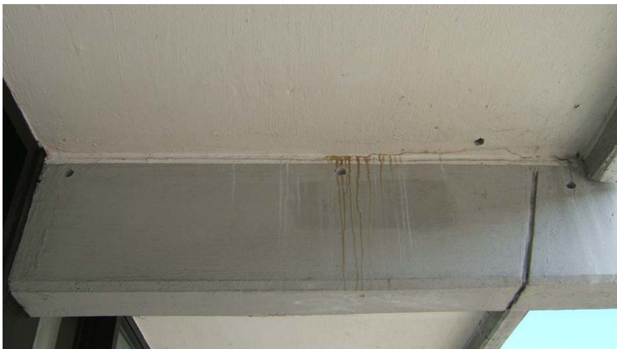
Foto 14: Område 3 1C/D, hvor der er ikke er målt EKP. Der er udtaget chloridprøver 4 steder (se borehuller). Bemærk gennemsivning og revnedannelse.
