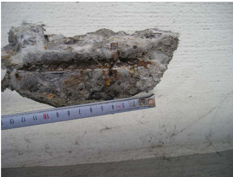
Foto 7: Ophugning 3. Underside af altangangsplade. Rustgrad 1 – 2.
