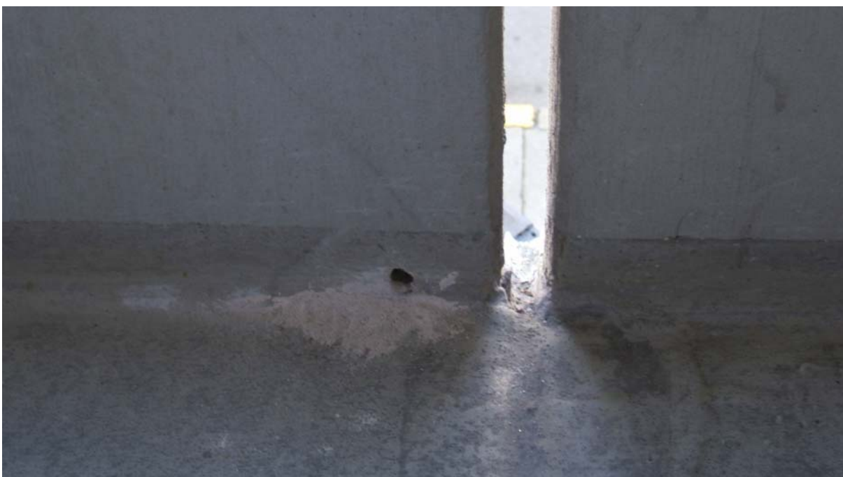
Foto 16: Chloridprøve (borehul) i brystning ved område 6 1P.
