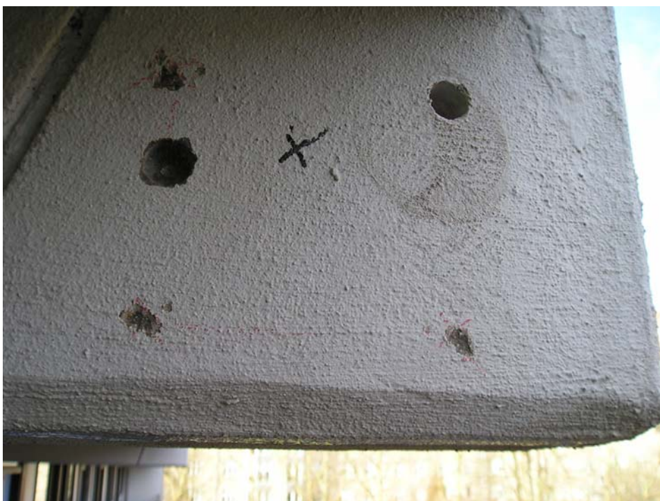
Foto 8: Borekerne 1 er udtaget ved X. Området er repareret. Chloridprøve 1A og 2A er udtaget til venstre herfor.
